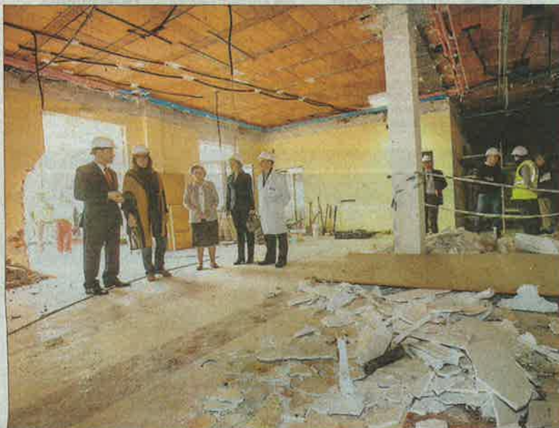
La presidenta de la Diputación, Ángeles Armisén, visitó las obras de las nuevas unidades. / EVA GARRIDO
